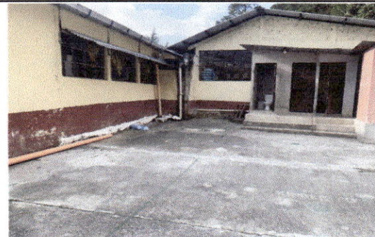
Foto 4: Patio trasero de escuela sin techo.
