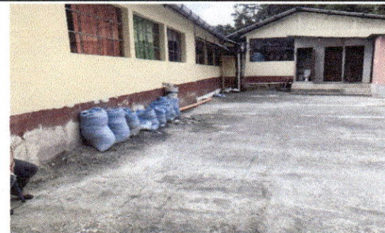
Foto 6: Fotografía del lugar en donde se realizará el remozamiento y paredes manchadas.
