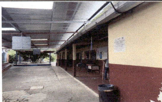
Foto 3: Estructura para techo en malas condiciones.
