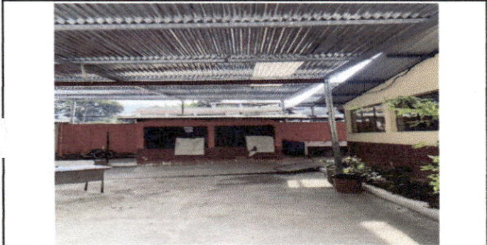
Foto 7: lamina en mal estado y con signos de corrosión.
